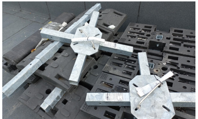
Warszawa R4R Białej Floty - bezwładne masy kotwiące do asekuracji prac na dachach
