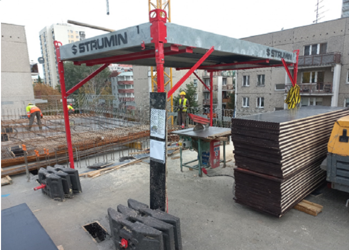
Warszawa - DS Modzelewskiego - wiata systemowa Strumin z balastem Strumin
