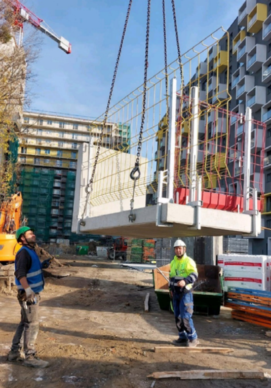
Wrocław Jaworska R4R — zabezpieczenia krawędziowe płyt balkonowych przed zamontowaniem balkonów / kotwy transportowe
