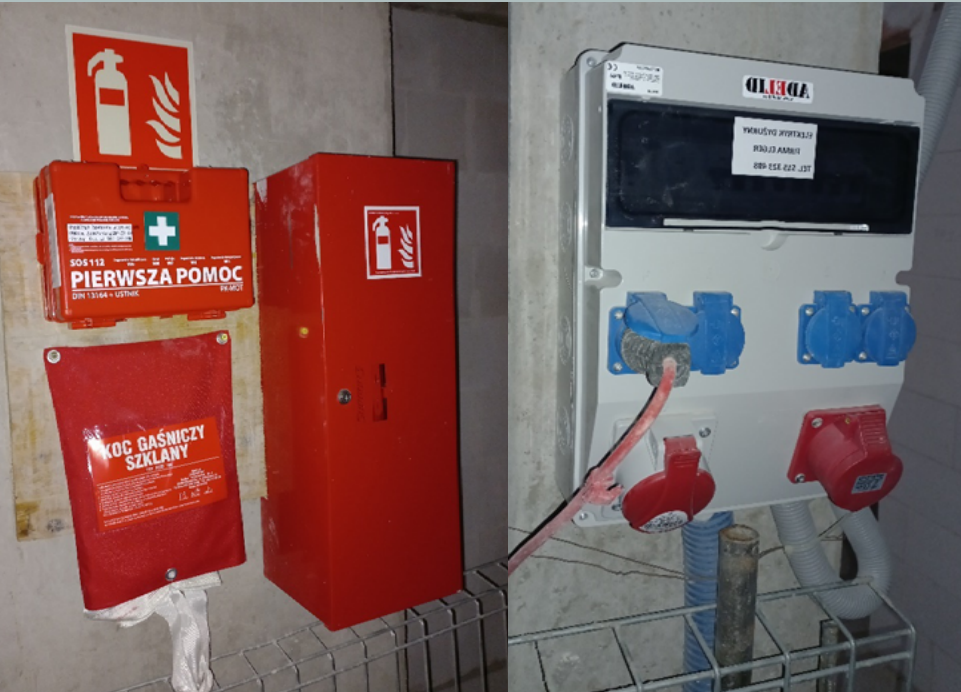
Łódź Fuzja F - punkty ppoż, szafka na gaśnice, rozdzielnice z bezpiecznikami w obudowie
