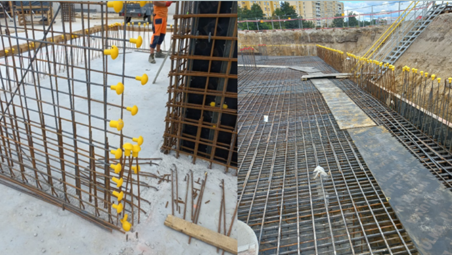
Wrocław Park Zachodni R4R — zabezpieczenie na prętach zbrojeniowych / Wyznaczone ścieżki komunikacyjne na zbrojeniu
