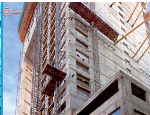
Fot. 40 Platforma masztowa
